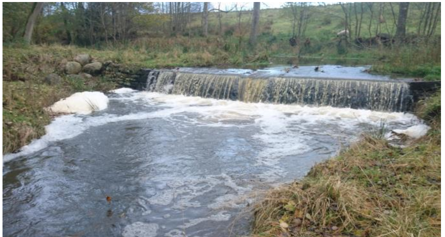
Figur 3.21: Overløbet i opstrøms ende. Styrtet er ca. 1,35 meter højt. Fordybningen i midten er 10 cm dyb og har en bundbredde på 75 cm. Foto: NIRAS 2017-11-15
