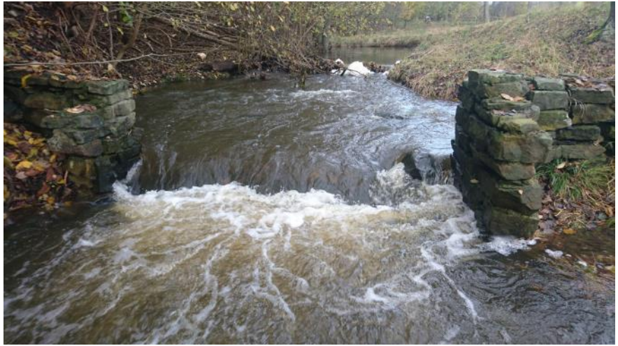
Figur 3.18: Ca. midt på omløbet er der en tidligere spærring opbygget i tilhuggede sten. Placeringen er markeret på Figur 3.3. Der er et styrt på 26 cm hen over den tidligere spærring. Opstrøms styrtet er faldet begrænset og vandstrømmen langt mindre end nedstrøms. Foto: NIRAS 2017-11-15
