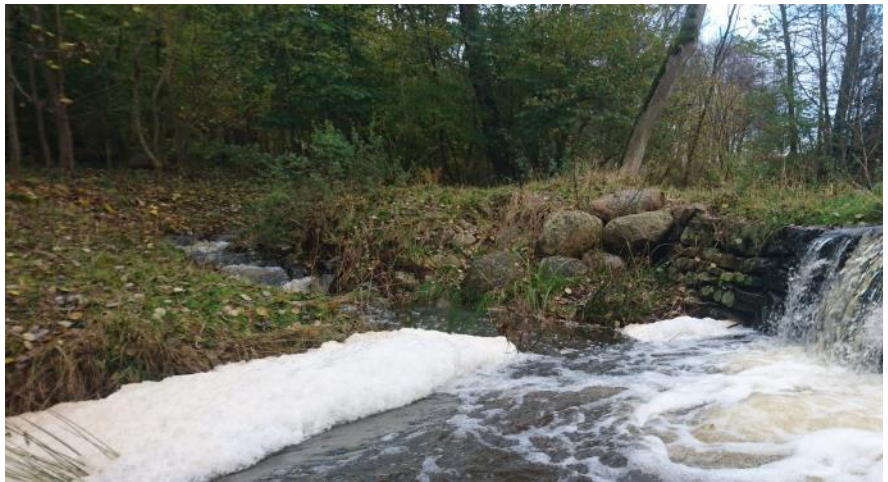
Figur 3.23: Omløbsstryget løbet til ved foden af overløbsstyrtet i dennes vestlige side. Der var en større mængde af skum nedstrøms overløbet og desuden svag lugt af spildevand. Foto: NIRAS 2017-11-15
