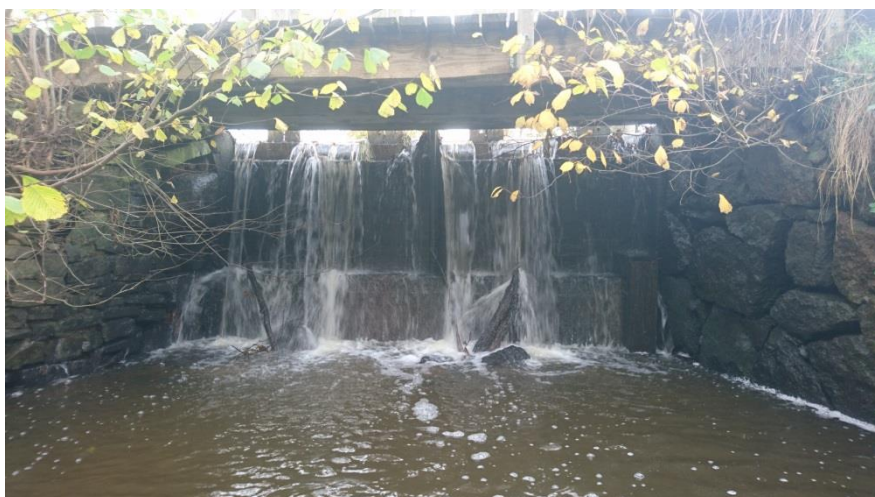
Figur 3.13: Slusen i opstrøms ende af friløbet. Selve slusen er i træ med kanterne støbt i beton. Nedstrøms slusen er siderne opbygget i granit og skiffer. Foto: NIRAS 2017-11-15
