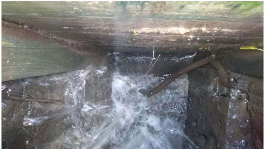
Figur 3.7: Begge sluser er særdeles utætte, både i bunden mellem slusen af træ og bunden af sten (top af foto), men særligt gennem fugerne mellem stenene i stenkisten der leder vandet videre. Foto: NIRAS 2017-11-15
