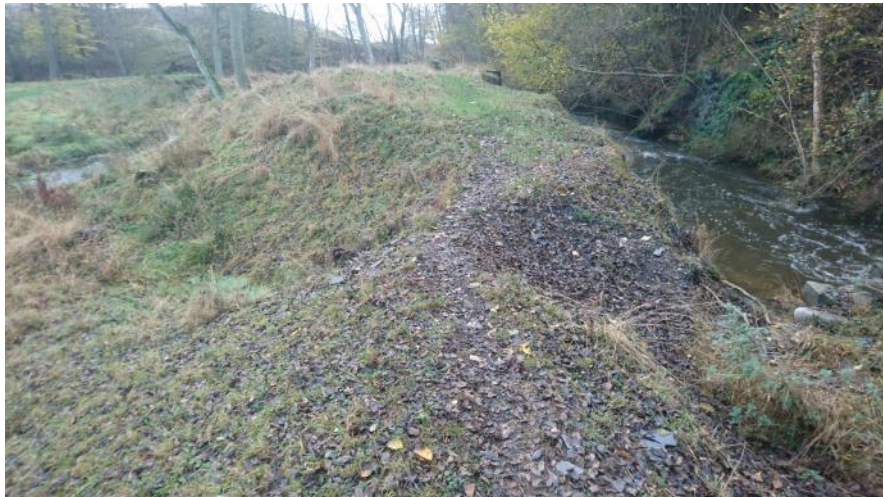
Figur 3.19: Den tidligere spærring (ses i fotoets nederste højre hjørne) er en hydraulisk begrænsning ved meget store afstrømninger, hvilket har skabt opstuvning og ført til digebrud, hvorved vandet har løbet fra omløbet og over i friløbet. Dæmningen er nødtørftigt repareret, men har væsentligt reduceret bredde af digekronen. Foto: NIRAS 2017-11-15
